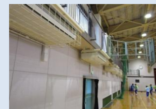
体育館に設置されたエアコン
