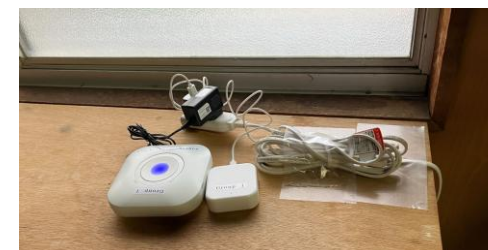
【NW機材】 ※ゲートウェイ・LTEルーター
