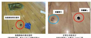
負傷者の発生箇所（事故発生後、速くには撤去済み）
