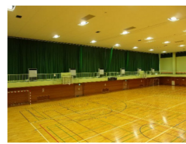
空調設置状況(遠景)
