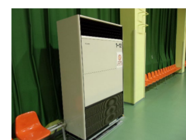
空調設置状況(近景)
