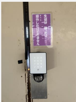
* 取り付け正面（外側）
