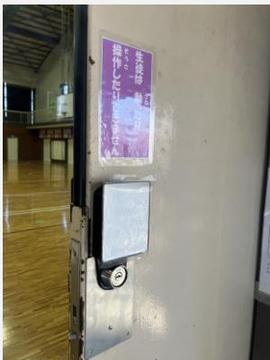
* 取り付け正面（外側）
