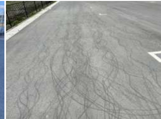
コンクリート面に残るブレイクボードのタイヤ痕 (さいたま市内)
