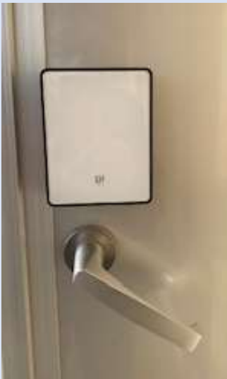
扉に設置されたテンキー
