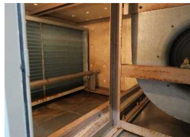
【空調設備（送風機）】
