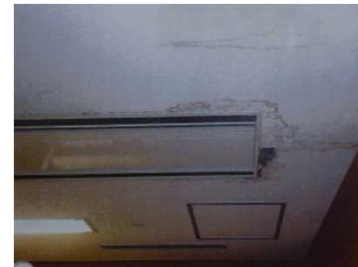
【空調設備（ファンコイル）】
