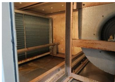
【空調設備(送風機)】
