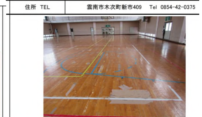
P-22 1階 アリーナ 床 ガムテープにて補修
