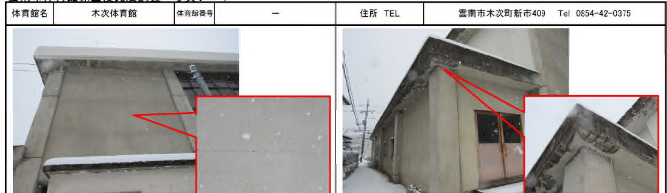
P-93 外壁 クラック
