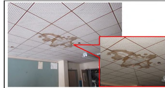
P-71 3階 ホール 天井 雨漏り跡 シミ
