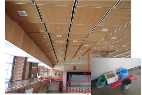
P-64 アリーナ 天井 雨漏り跡
