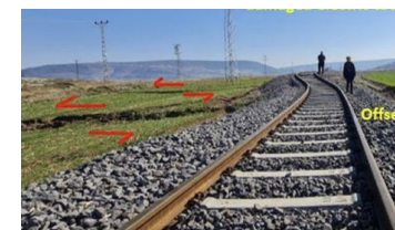
▼地震による土木地盤被害（トルコ中東工科大学）
