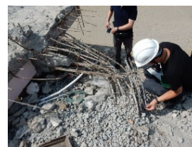
▼構造物被害の現地調査（東京大学地震研）
