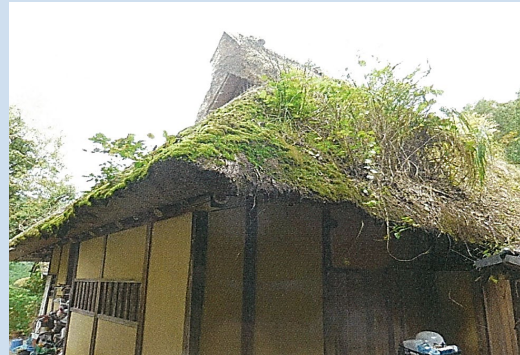
修理前（南東から）
