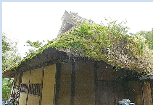
修理前（南東から）
