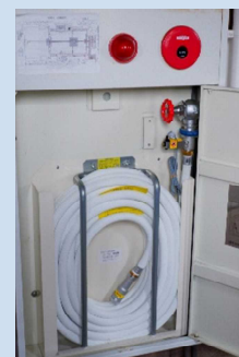
一人で操作できる屋内消火栓
