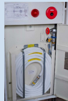
一人で操作できる屋内消火栓
