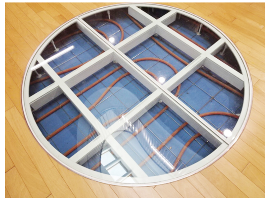
ヒートポンプを効率的に活用し、冬季の過乾燥を防ぐ低温水床暖房システム
