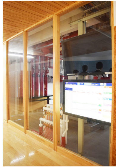
ガラス張りの機械室。表示モニターに地中熱ヒートポンプによるエネルギー量と太陽光発電による発電量が表示されている。
