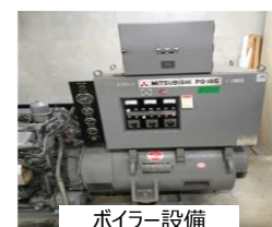
ボイラー設備
