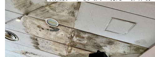
雨漏りによる天井の様子（日高）
