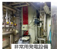
非常用発電設備
