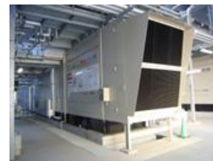
コジェネレーションシステム
