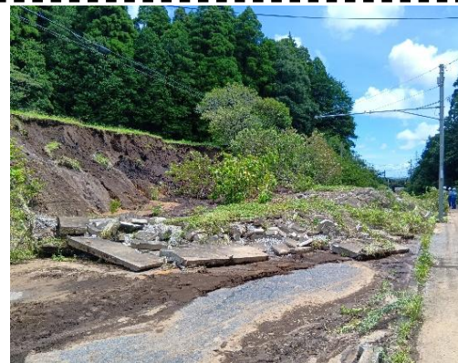
法面崩れ(千葉県千葉市緑区)
