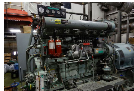
発電機（1号機）1996年
