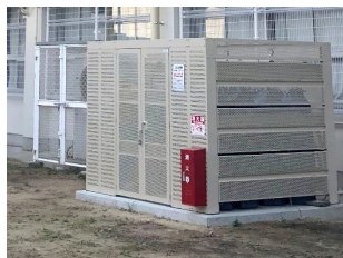
体育館空調設備用のLPガスポンペを収納
