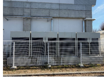
体育館外周部に室外機を集約配置し、維持管理や更新時の作業性に配慮
