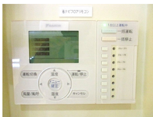
体育館全体の空調運転を一元管理し、スケジュール管理や消し忘れ防止機能に対応
