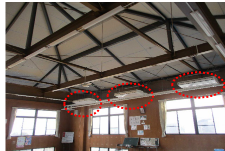
天井吊型空調機
