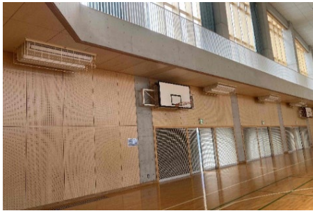
天井吊型空調機
