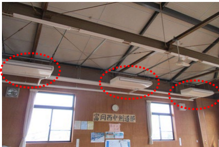
天井吊型空調機
