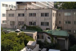
老朽化と機能劣化が著しい校舎
