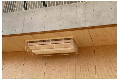
天井吊型空調機
