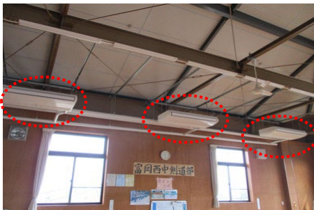
天井吊型空調機
