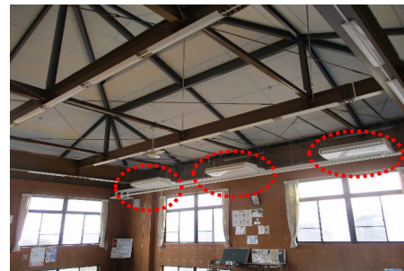
天井吊型空調機
