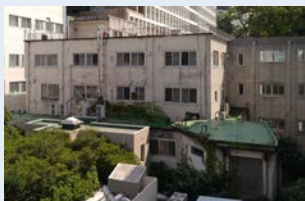
老朽化と機能劣化が著しい校舎
