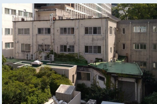
老朽化と機能劣化が著しい校舎
