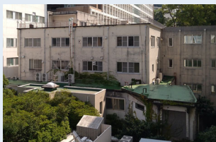
老朽化と機能劣化が著しい校舎
