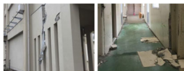
激甚化・頻発化 する災害への対応 (地震における外壁・内壁落下)
