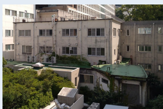
老朽化と機能劣化が著しい校舎
