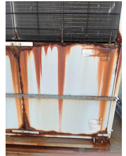
室外機の外装パネルの著しい腐食
