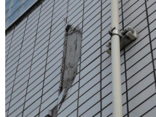
外壁タイルの落下(有明高専)
