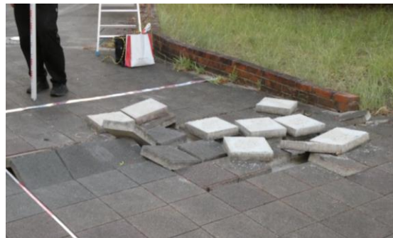
舗装の破損 熊本高専(八代キャンパス)
