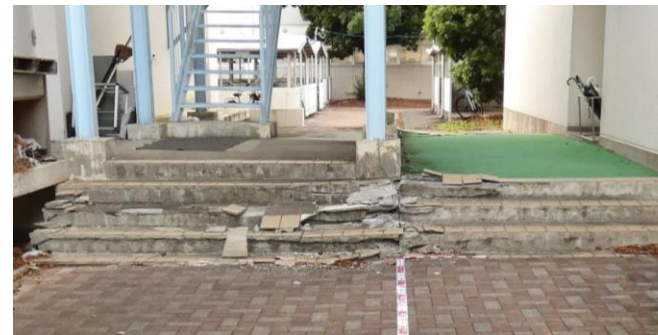
屋外階段の破損 熊本高専(八代キャンパス)
