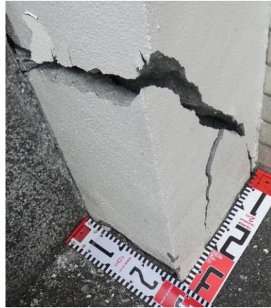
柱のクラック 熊本高専(八代キャンパス)
