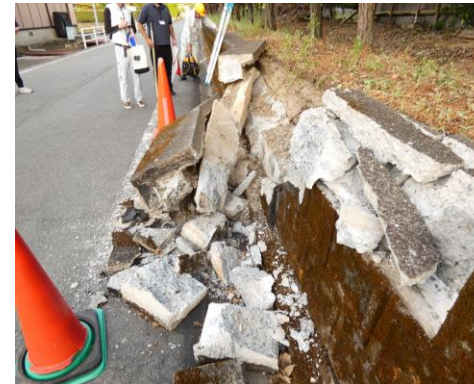
擁壁の崩落 熊本高専(八代キャンパス)
