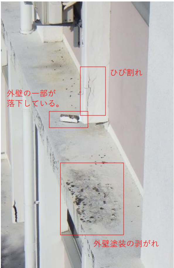
鳥羽高専（2号館） 外壁塗装の剥がれや、ひび割れが発生しており、雨漏りや外壁の落下等の危険性がある。
