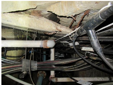
呉高専（共同溝内ライフライン） 共同溝の天端が崩落しており、構内の各ライフラインに支障が生じている。
