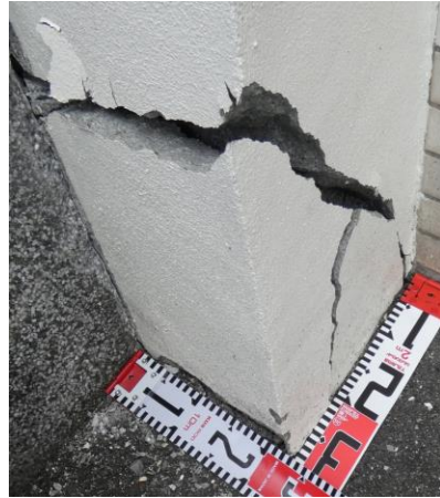
柱のクラック 熊本高専(八代キャンパス)
