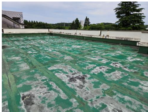
八戸高専（ゼミナール棟） 屋上防水は、経年による老朽化と凍害により下地・防水層の割れが多数みられる。
