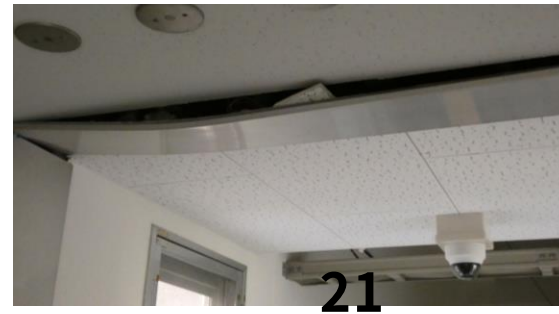
エキスパンションジョイントのゆがみ 熊本高専(八代キャンパス)
