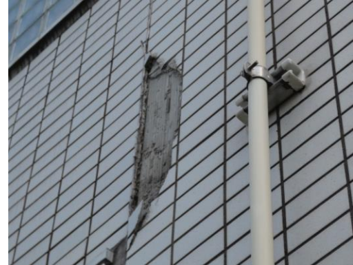
外壁タイルの落下(有明高専)
