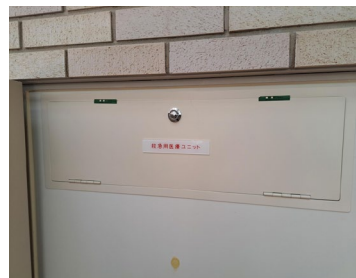
救急用医療ユニット (非常電源コンセント・医療ガス収納)
