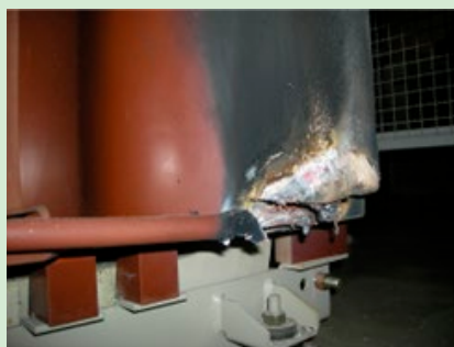
変圧器の発火による損傷
