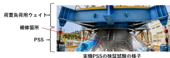
図 6.1.3-2 実機 PSS の検証試験の様子
