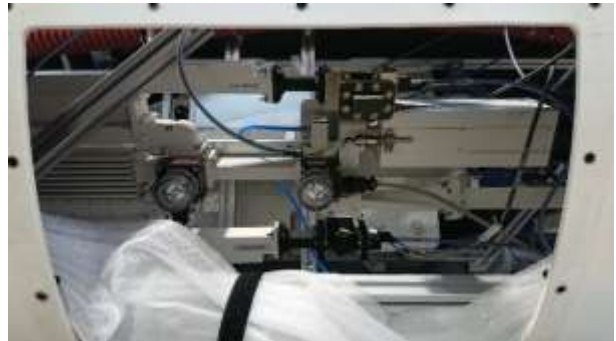
図 3-2-5. 給電部内の機器配置の様子
