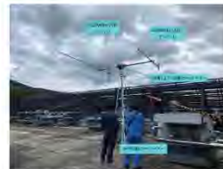
北陸教育研究棟屋上に設置されたアンテナ
