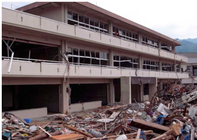
津波により被害を受けた校舎
