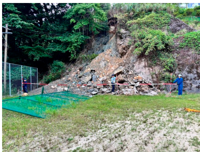
大雨被害による学校敷地内の法面崩落（熊本県八代市泉小中学校）
