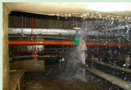
配管からの漏水
