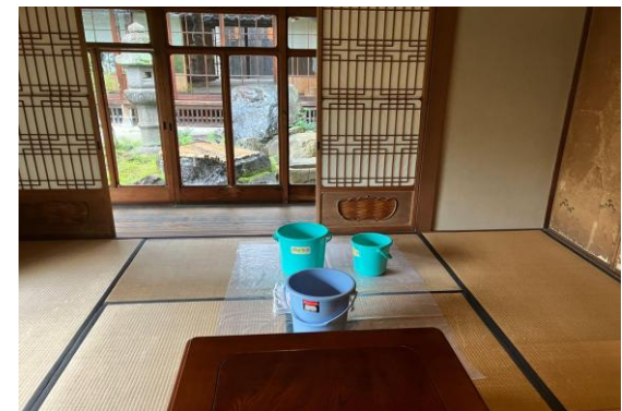
旧梶村家住宅：雨漏状況
