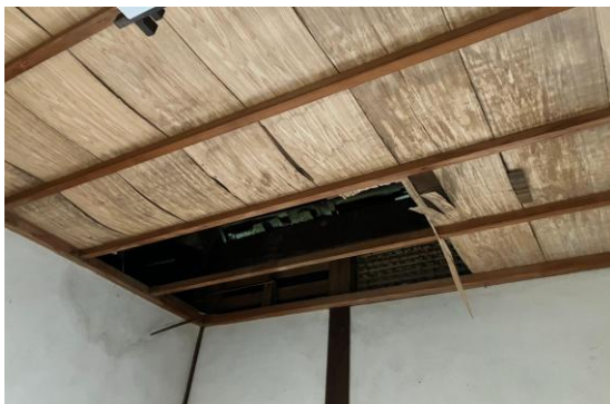
鶴山館：天井破損状況
