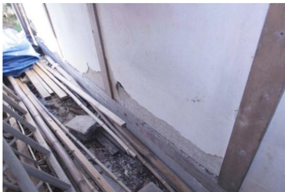
衆樂園：外壁破損状況
