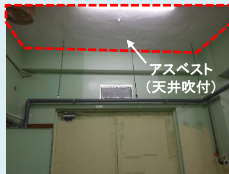
アスベスト(撤去前)
