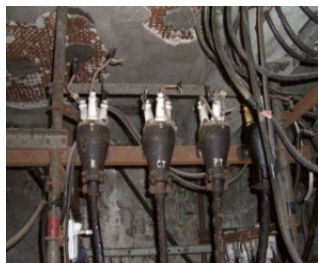
電気ケーブルの劣化
