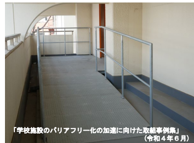
校舎-体育館のスロープ (バリアフリー化)の整備例
