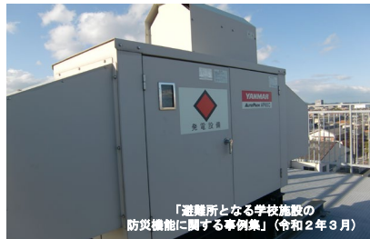
屋上に設置された自家発電機 (非常用発電機の整備例)
