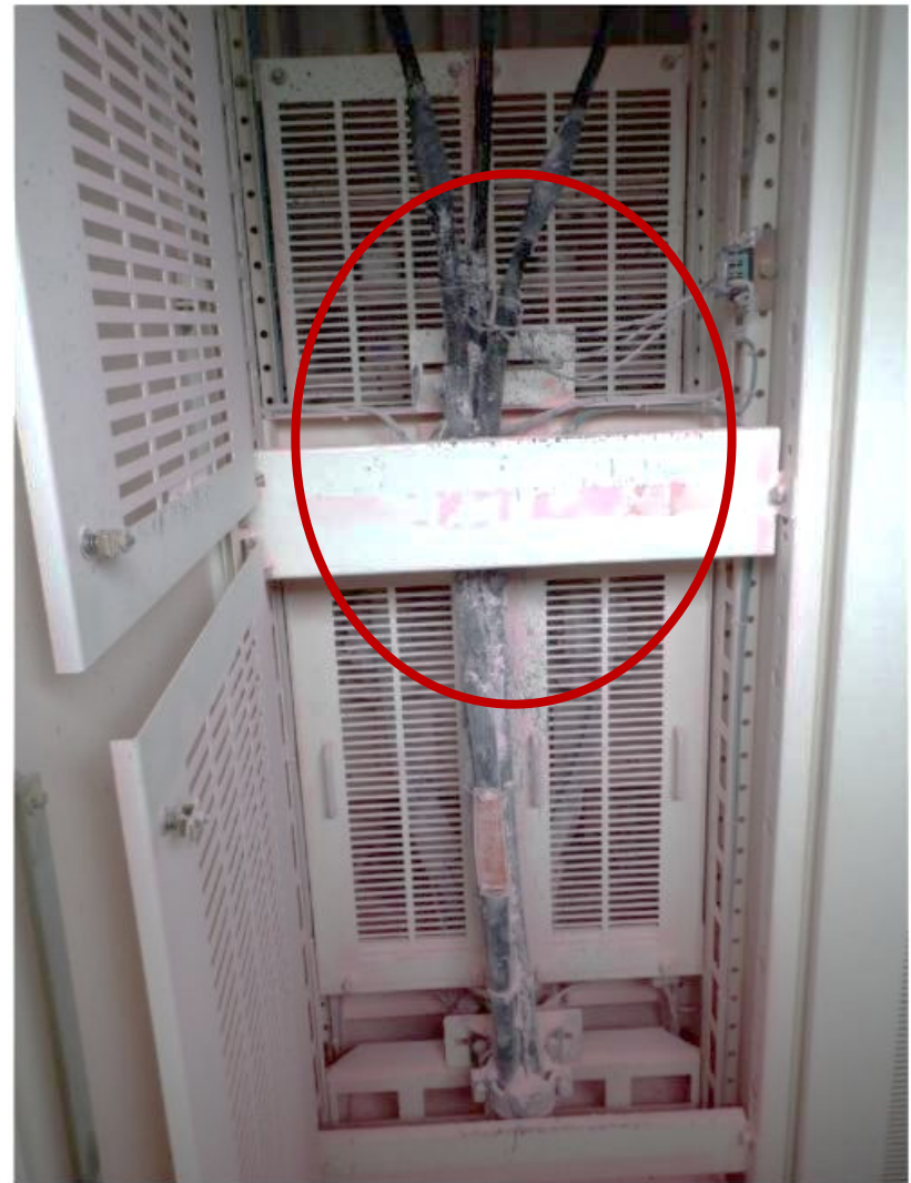
出火した高圧配電盤内ケーブル（盤背面） ピンク色の付着物は消火剤である
