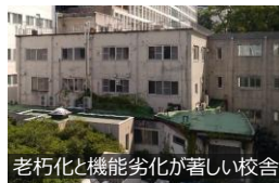
老朽化と機能劣化が著しい校舎
