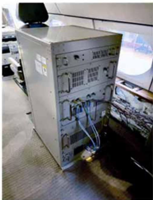
SAR機器ラック(機内)
