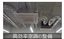
高効率空調の整備
