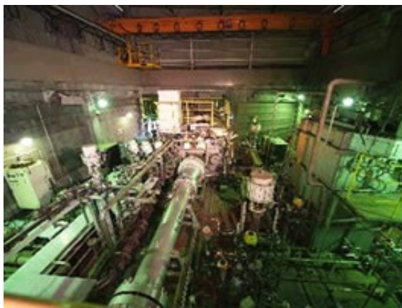
ラムジェットエンジン試験設備(RJTF) ラムジェット、スクラムジェット、ロケット複合エンジンなどの超音速・極超音速空気吸込み式エンジン模型の燃焼試験用風洞
