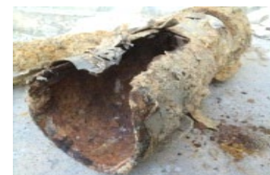
配管の腐食（給排水管）
