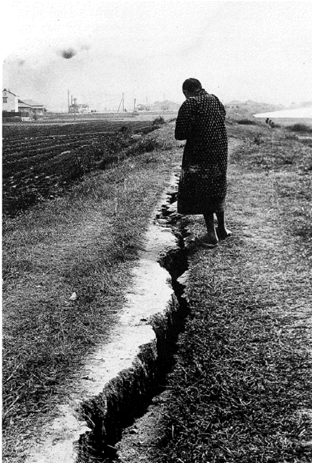
鹿児島市街地を流れる川の土手に出来た亀裂
