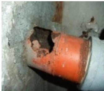
劣化による配管破損
