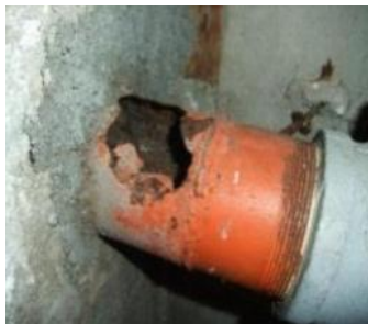
劣化による配管破損
