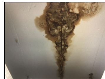
雨水侵入状況
