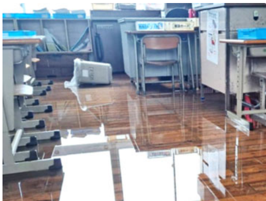
大雨被害により床上浸水した教室
