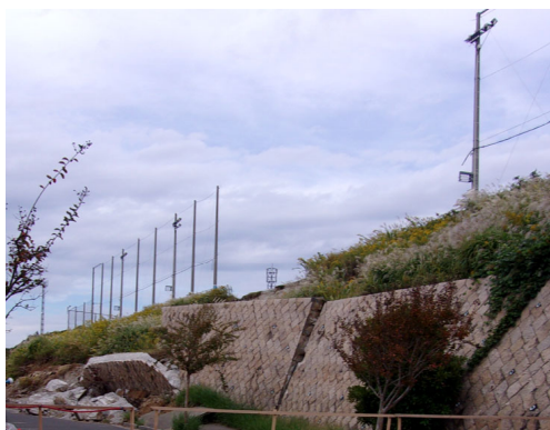
大雨被害によるグラウンドの法面擁壁崩壊
