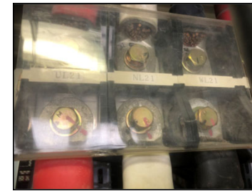
端子接続部の発錆
