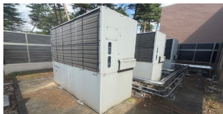
空調室外機（設置後16年）
