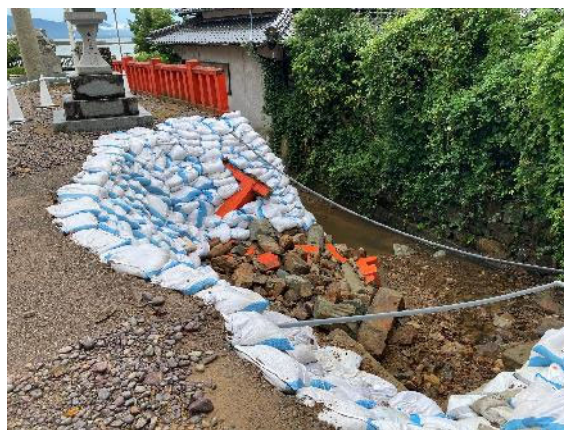
史跡宗像神社境内 （福岡県宗像市 ※世界文化遺産 構成資産） 令和7年8月豪雨による中津宮参道の崩落
