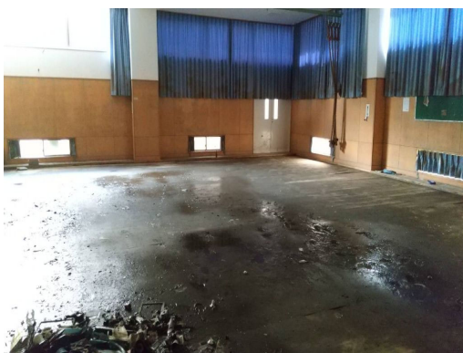
大雨被害による柔道場の床上浸水
