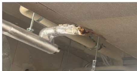
腐食が進んだ空調室内機
