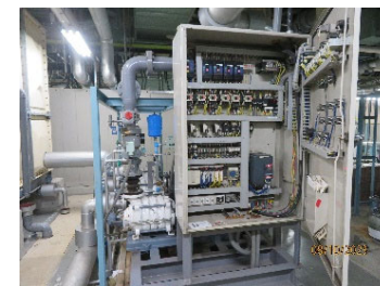
桜地区 ポンプ自動制御盤
