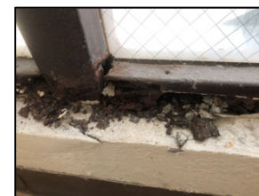
塩害によるサッシ まわりの腐食状況
