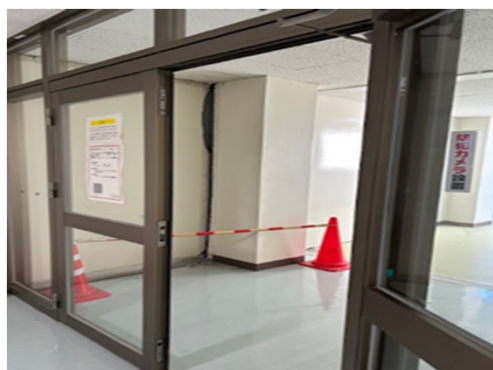
地震による建物破損
