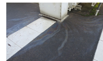
第1特高からの絶縁油漏えい （応急処置で対応）
