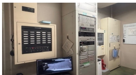
老朽化した防災設備
