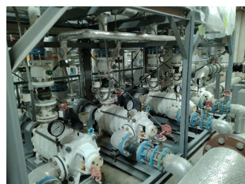
給排水配管設備
