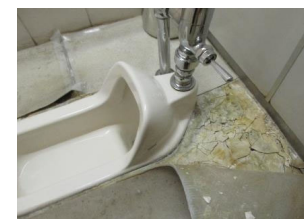
トイレの床の腐食・破損 (東京本部)
