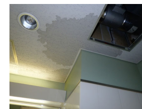
トイレの洗面用給水管からの漏水 (東京本部)
