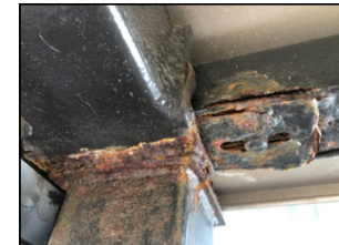
塩害による鉄部の 腐食状況
