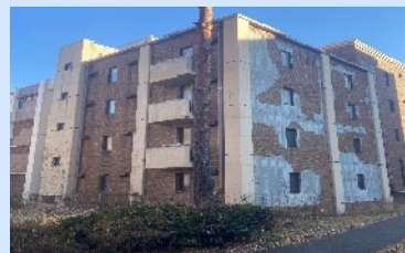
外壁の剥離、落下
