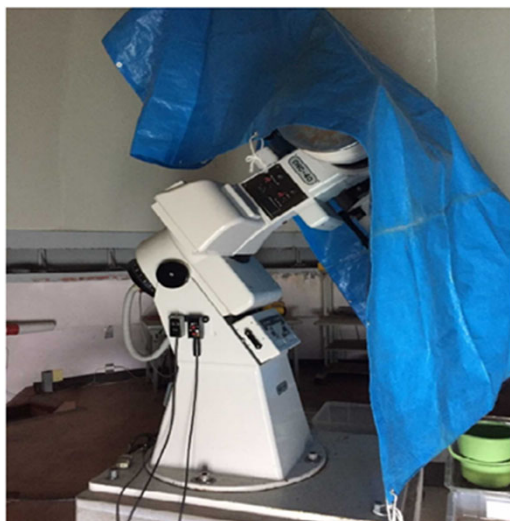
豪雨による雨漏り
