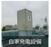
自家発電設備
